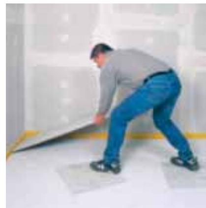
Posa di FERMACELL lastre per sottofondo su FERMACELL livellante granulare camminando su "isole di lavoro"
