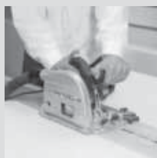
f. Taglio con sega circolare manuale a tuffo con profondità dell'incisione controllata e velocità regolabile.
